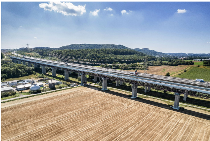
(1) Die Sanierung der 14 Brückenpfeiler und -köpfe der Eisenbahnüberführung Itztalbrücke wurde im Juni 2024 erfolgreich abgeschlossen.
